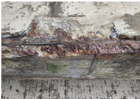
b) 码头开裂横梁
