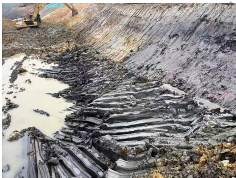
a) Ⅰ号边坡冲沟位置
