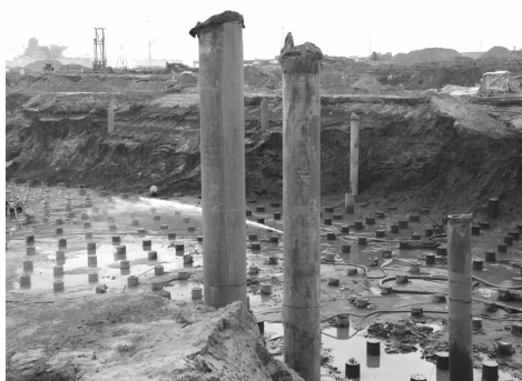
图1 桩头破损和桩身开裂
