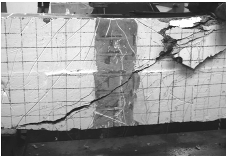
图 9 试验梁 JQL2 破坏形态
