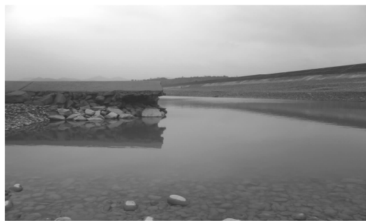
图 2 小米滩丁坝坝根水毁情况
