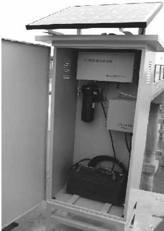
图 6 水位站一体化仪器房
