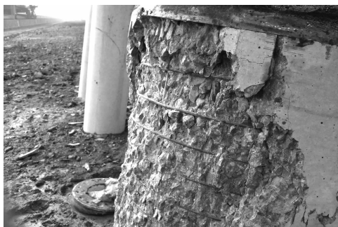
图3 桩身外侧骨料较大且不均匀
