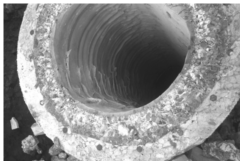
图4 混凝土内外侧骨料不均
