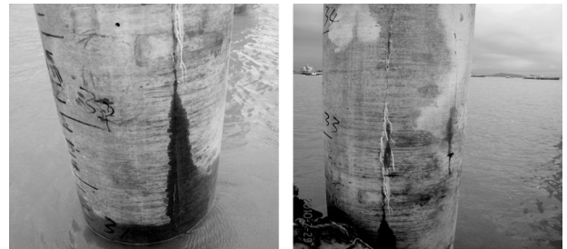
图5 B、C结构段桩顶纵向裂缝
