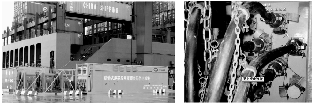
图5 低压电缆连接船舶接电屏
