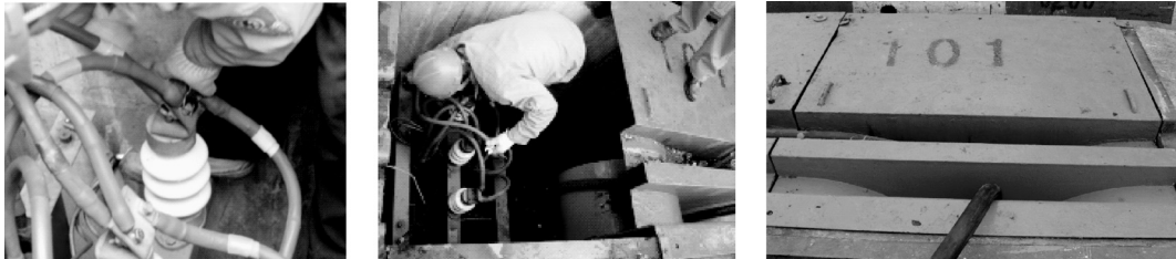
图4 工人将高压电缆连接至码头前沿的10 kV/2 000 kVA/50 Hz的高压电箱
