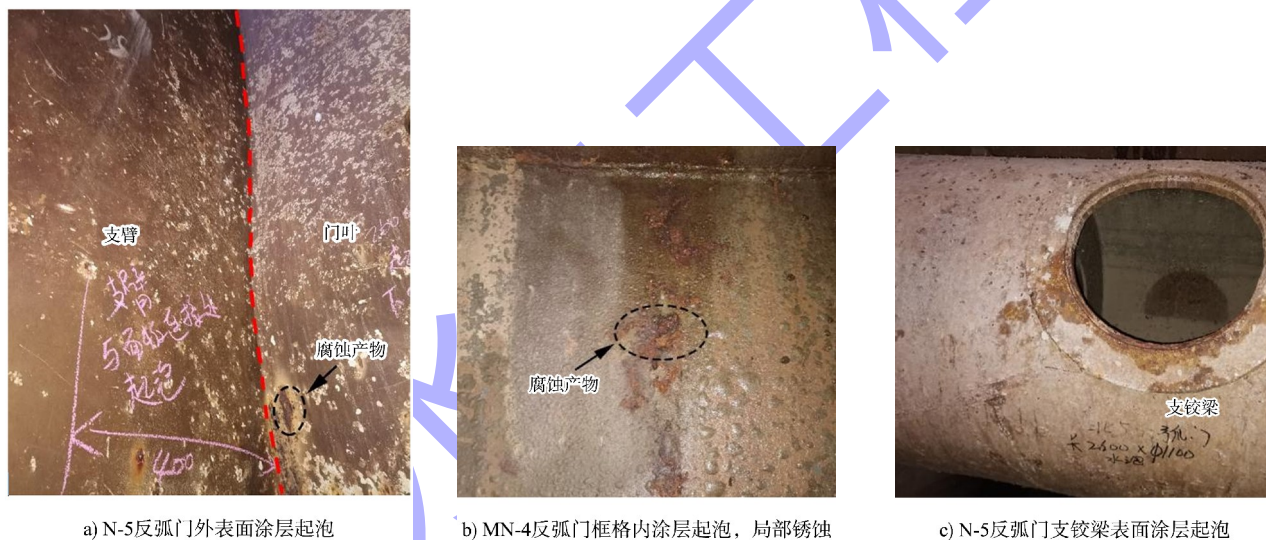
图3 门叶上游框架面及框格内涂层起泡状况
