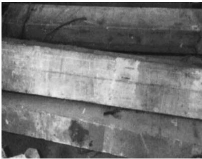
图 4 C、D 级锈蚀构件
