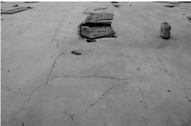
a) 平行和垂直于码头岸线方向的长裂缝
