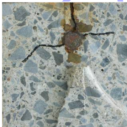
b) 钢筋锈蚀量 352 \text{ mg/cm}^2 对应截面裂缝
