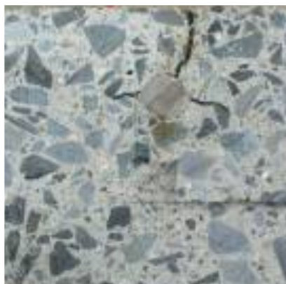
a) 钢筋锈蚀量 182 \text{ mg/cm}^2 对应截面裂缝
