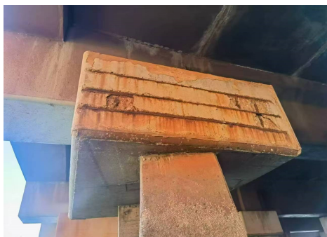
b) 结构裂损2
