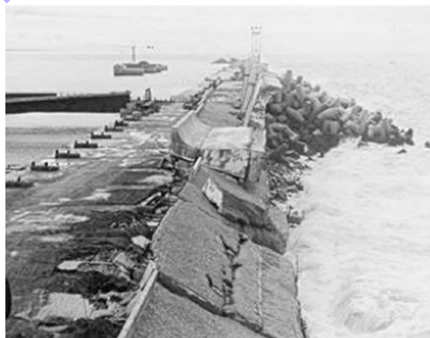
图 4 防波堤现场破坏照片
