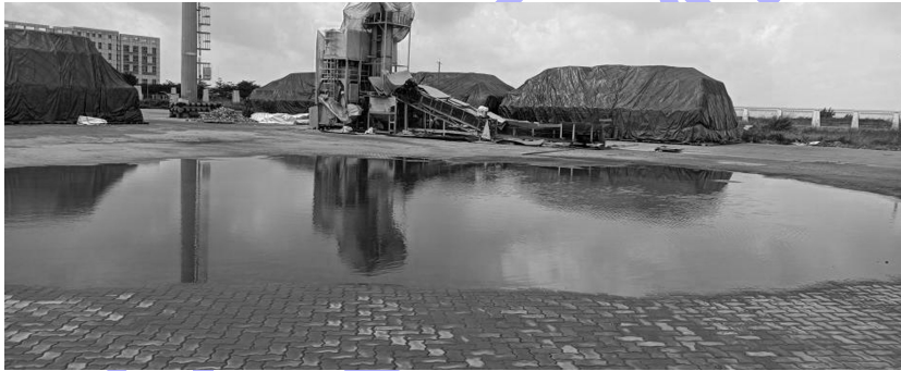
图 6 4号堆场现状积水
