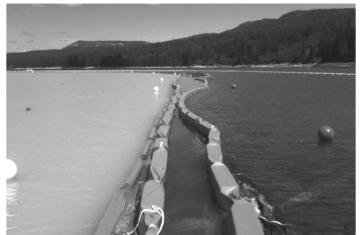
图9 港口疏浚中的拦污屏
