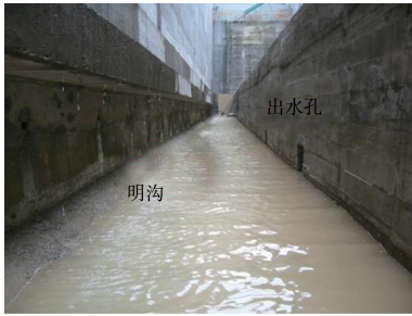
图 2 明沟消能设施
