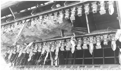
图5 A 施工区亚黏土造成耙头堵塞
