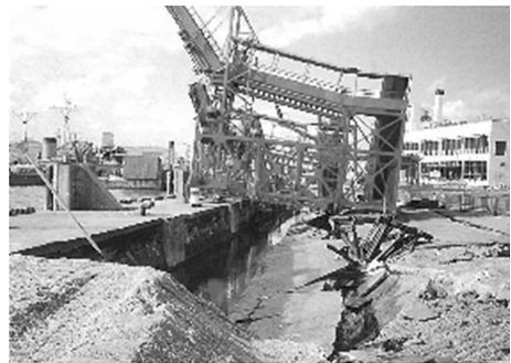
图2 码头与起重设备的破坏（东部工区地区）
