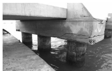
图4 典型梁与基桩受损情况
