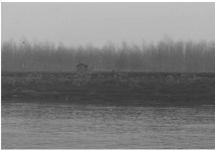
图 3 斗湖堤河段出口段左岸窑头埠一带崩岸状况
