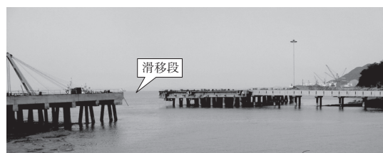
图2 7#码头滑坡后现场照片
