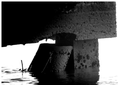
图3 斜桩沉降脱离桩帽
