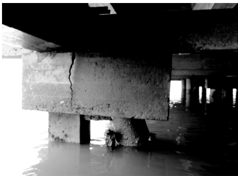
图2 斜桩沉降桩帽开裂
