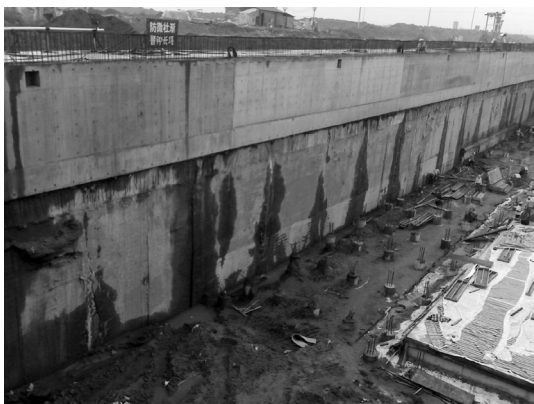
图2 墙后压力水沿着地下连续墙接头缝隙渗透进来
