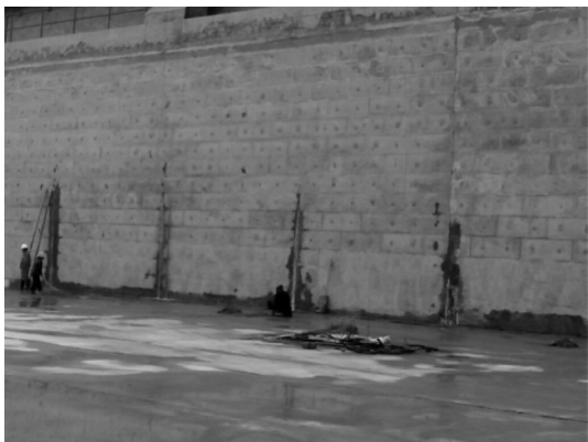
图1 裂缝处局部渗水
