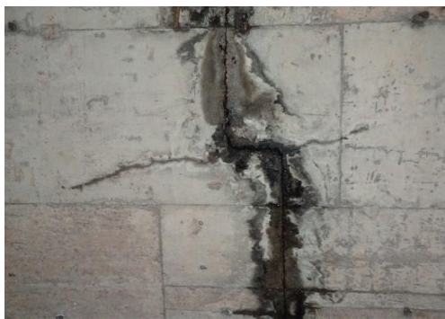
图 1 码头现状裂缝
