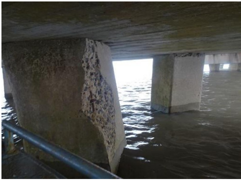
图 4 桩基破损情况 Fig. 4 Pile foundation damage situation
