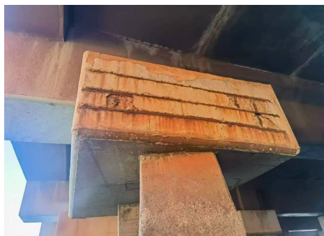
b) 结构裂损2
