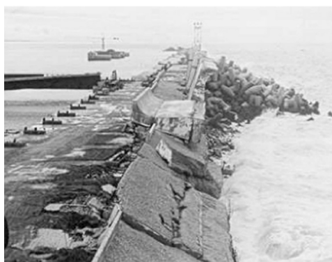
图 4 防波堤现场破坏照片
