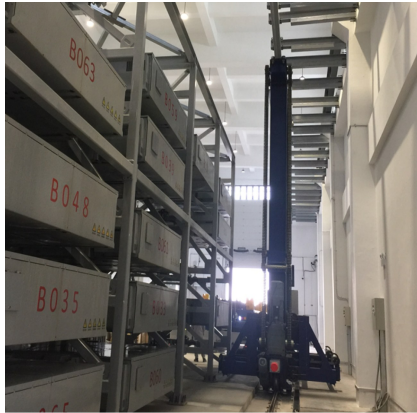
a) 侧面掏取式换电站（洋山四期）
