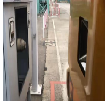
a) AGV充电桩（天津北疆C段码头）
