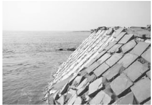
图1 混凝土系结排护滩结构边缘破坏情况
